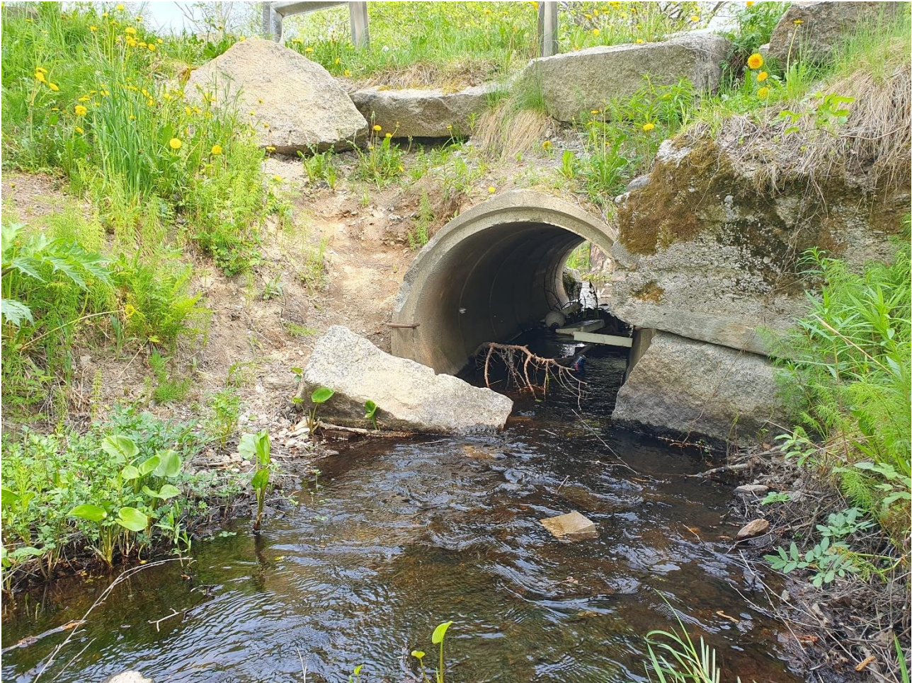
Kuva 3 Roskaisuuden aiheuttama tukos rumpuputkessa.
